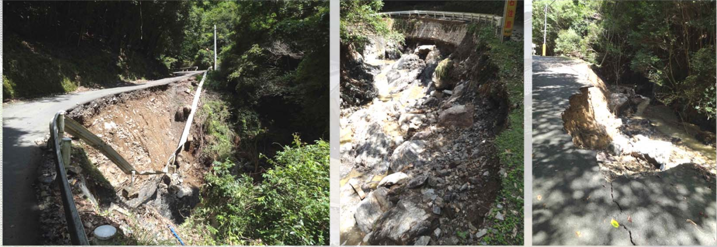
(a) 池ノ尾川で発生した湾曲外岸部の河岸浸食
