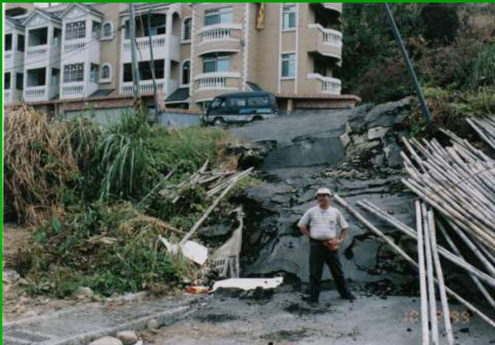
大きな縦ずれが生じた豊原市の地盤
