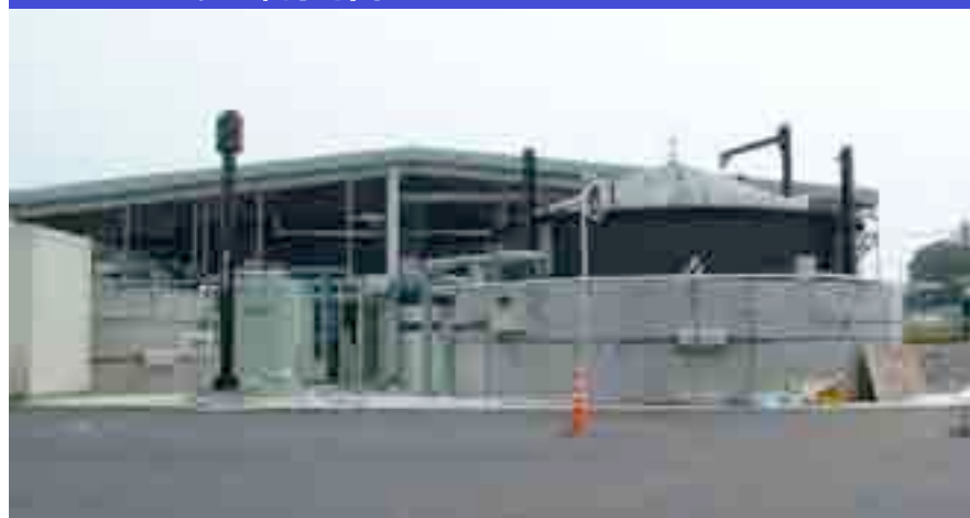
メタン発酵槽
