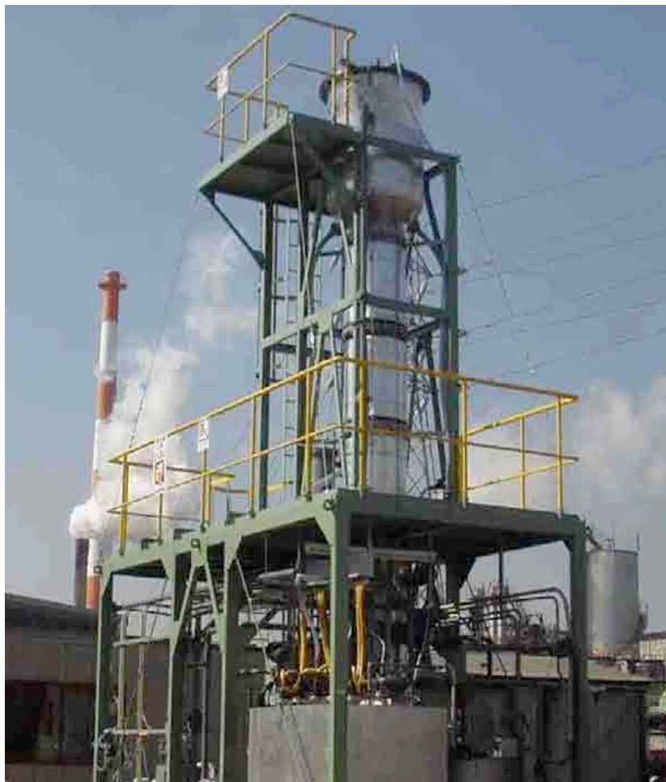
排水処理テストプラント
